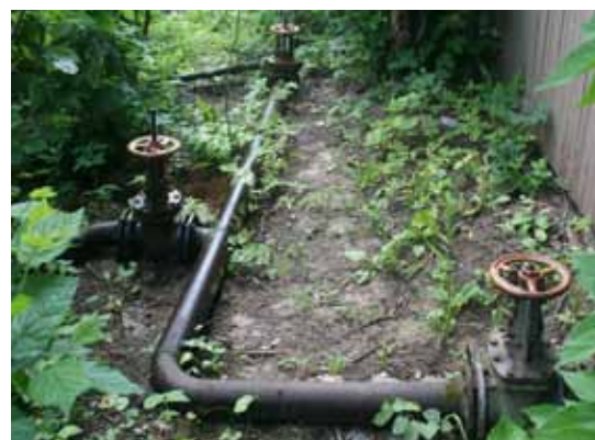
Задвижки водонапорных труб должны быть доступны
